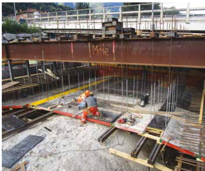
7. La predisposizione della centina per il getto della soletta della nuova galleria
