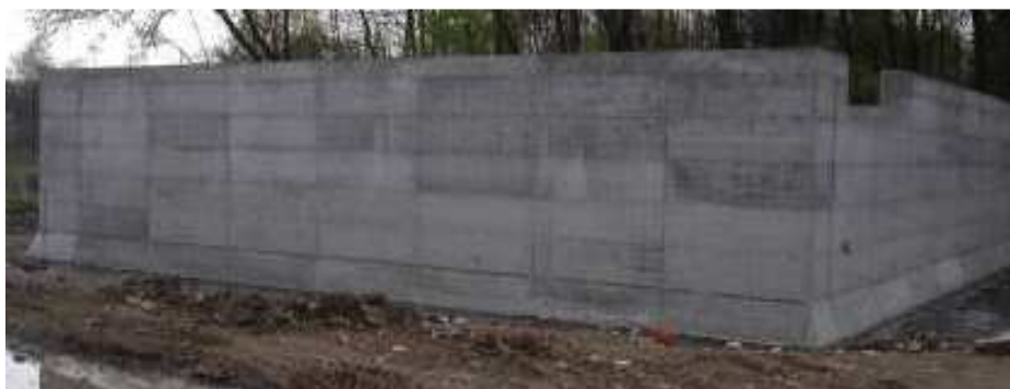
Parte fuori terra della vasca di omogeneizzazione
